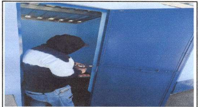
Foto 2: Sustitución de puertas de madera por puertas de metal en servicios sanitarios.
